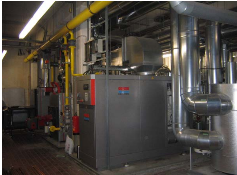
BHKW 147 kW elektr.
